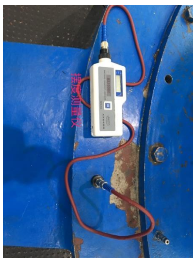
机组运行摆度测量
