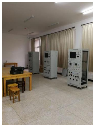
电气二次安装实训室
